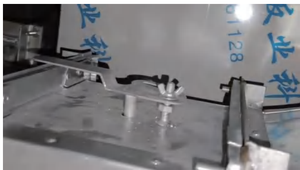
图3 管道阀门开启情况
